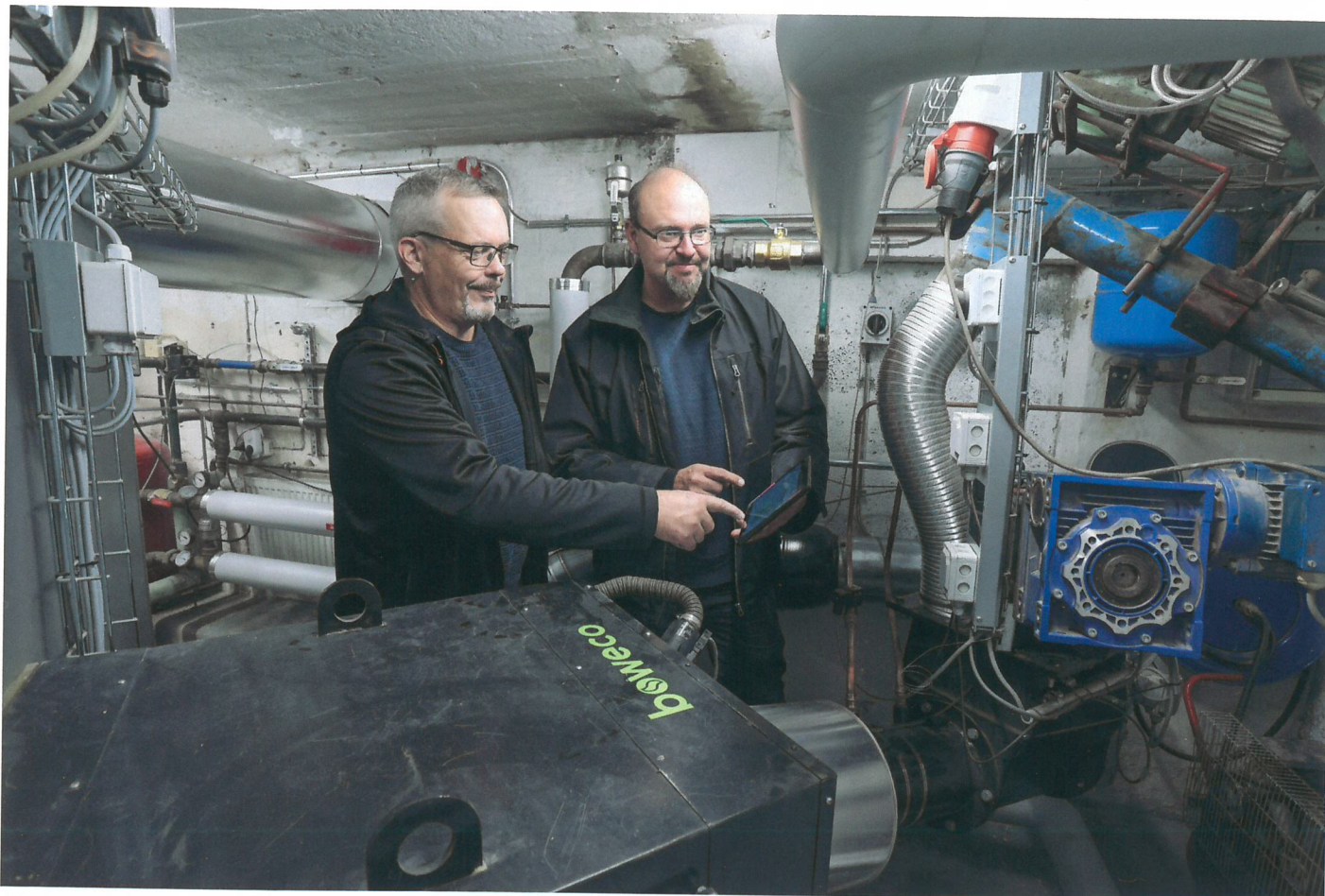
Lauri Ylä-Ajos (oik.) ja Tauno Tarvainen ovat tyytyväisiä lämpölaitteiston toimintaan. Tehoa riittäisi vielä isompaankin lämpöverkoston.
