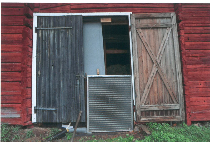
Heinäkuivurissa on myös oma lämmönvaihtimensa, tehoaan 120 kW. Kuivan hevosheinän tuotanto onnistuu näin myös toisesta sadosta.
