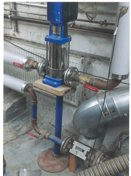
Suurtehopumppu siirtää lämpimän veden kuivureille menevään lämpökanaaliin. Lattian rajassa näkyy verkostoon menevän tehon energiamittari.
